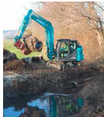
Entfernung der Betonröhren, welche bisher den See mit dem Rückhaltebecken verbanden. (R. Hardegger)
